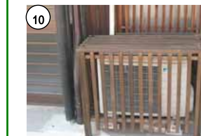
建築設備への目隠し
